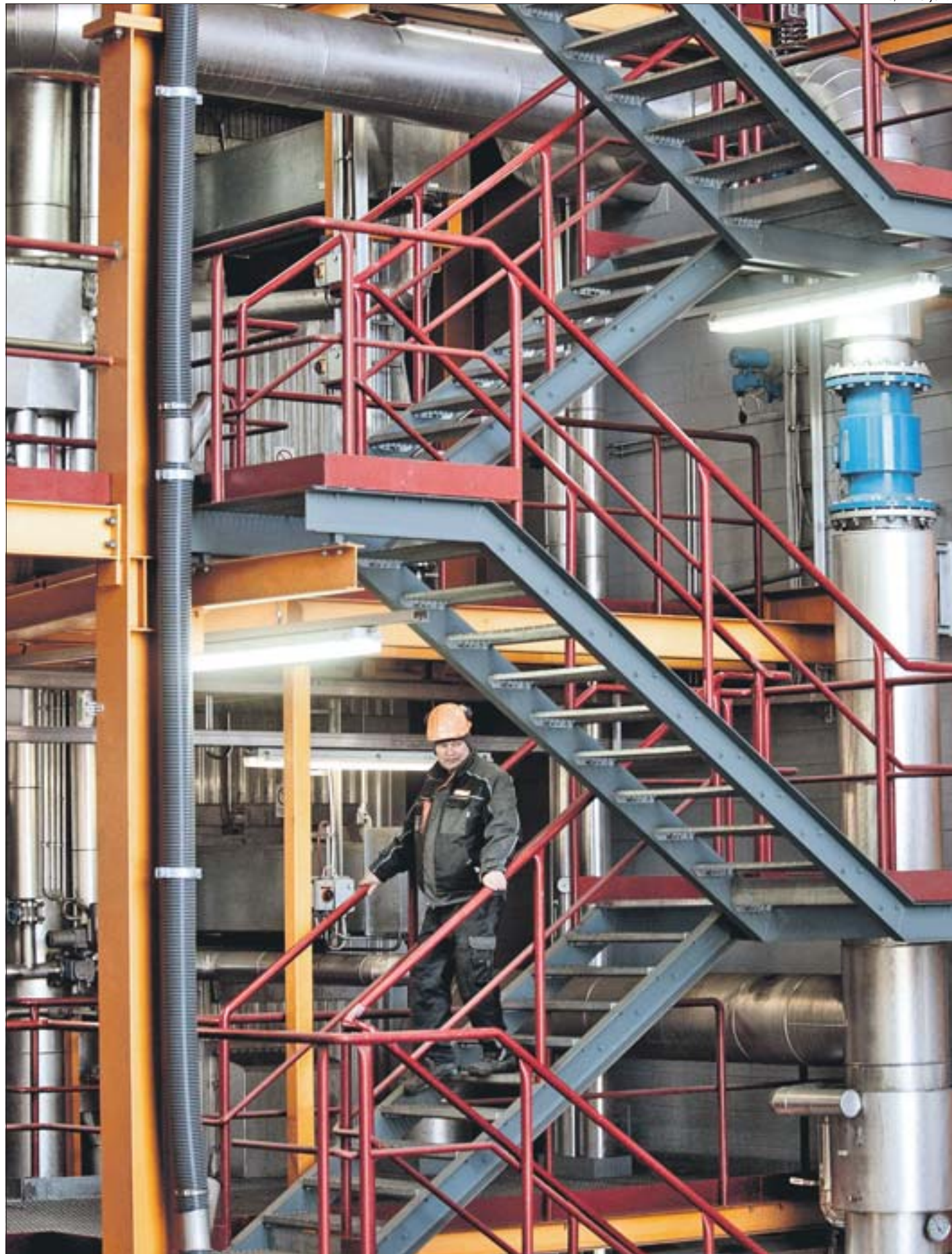
Oriekedon biolämpökeskus siirtyy Turku Energialta TSME:lle, jos seudullinen energiatarvikkeista toteutuu. Laitosmies Jarmo Vehviläinen kierroksella.
